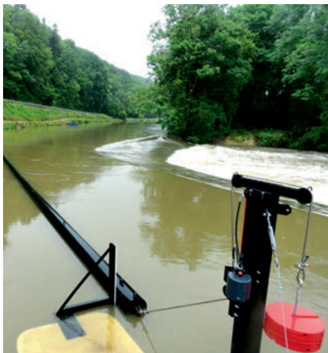
Drome (avec système de contrepoids) pour détourner les objets flottants - Centrale de Ray-sur-Saône (70)
