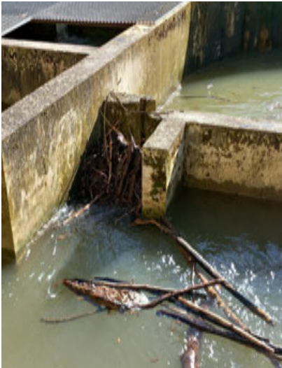
Les amas d'embâcles peuvent diminuer le débit circulant dans la passe à poissons
