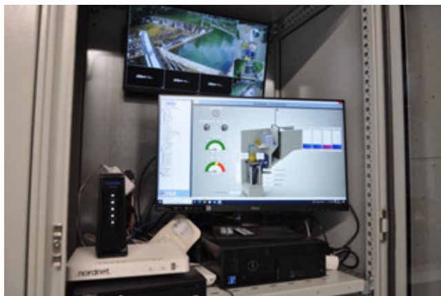
Écrans de supervision - Centrale de Conte (39)
