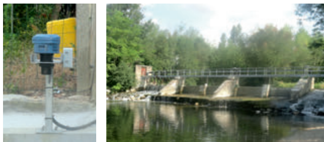
Sonde de niveau et vannes au seuil – Moulin de Champdôtre (21)
