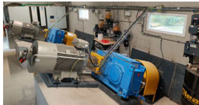
La centrale de Roffey (89) dispose de deux vis hydrodynamiques qui entraînent chacune un multiplicateur à engrenages (en bleu) couplé à une génératrice asynchrone (en gris)
