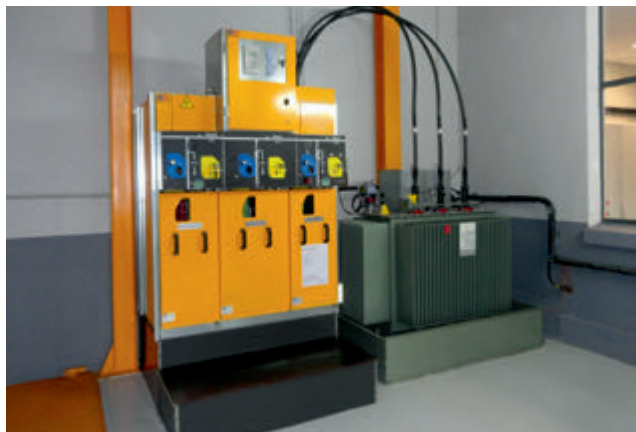
Cellules HTA (à gauche) et transformateur (à droite) - Centrale de Ray-sur-Saône (70)
