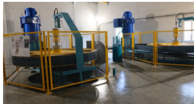
Turbines Kaplan équipées de multiplicateurs par poulie-courroie et de génératrices synchrones - Centrale d'Emagny (25)
