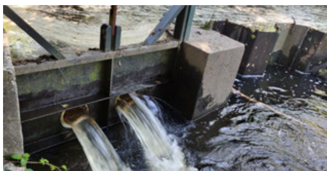
Orifices calibrés réalisés dans une vanne pour l'écoulement du débit réservé.
