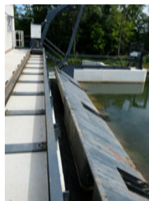
Le dégrilleur pousse les feuilles et embâcles dans une goulotte qui peut servir aussi à la dévalaison des poissons - Centrale d'Emagny (25)
